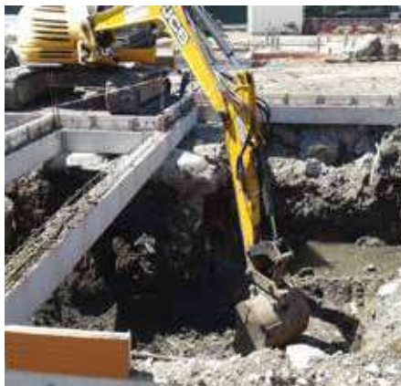
Exemple de travaux non anticipés
