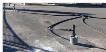
Puits et réseaux d'extraction des gaz
