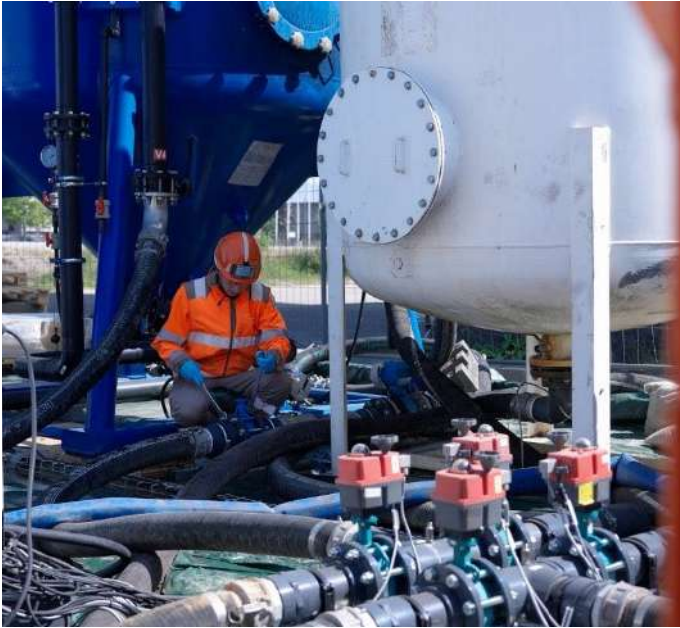
Fig. 2 : Intervention d'un technicien spécialisé de COLAS Environnement pour le suivi et la maintenance d'un process de traitement des eaux impactées en PFAS
