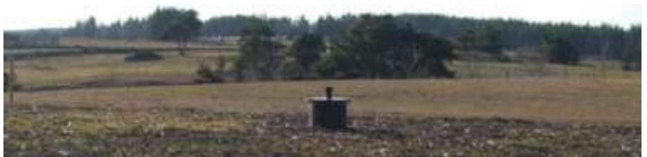
Fig. 9 : Dégazage passif par biofiltre
