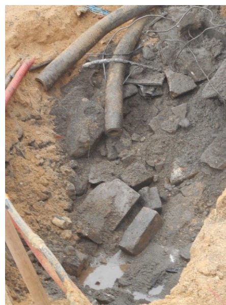
Fig 3 : Mise en évidence de la fosse avec des déchets souillés par des hydrocarbures
