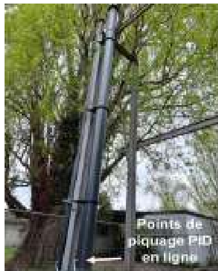
Figure 4 : Cheminées de rejet des gaz traités atmosphériques.
