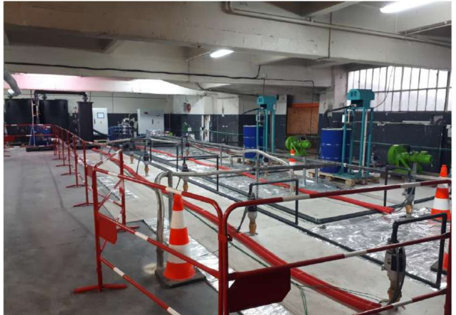
Figure 3 - Photographie du dispositif de traitement des sols / écrémage nappe de la zone d'étude
