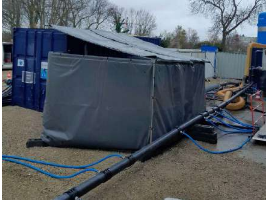
Figure 3 : Bâches acoustiques installées autour de la pompe de l'EMP
