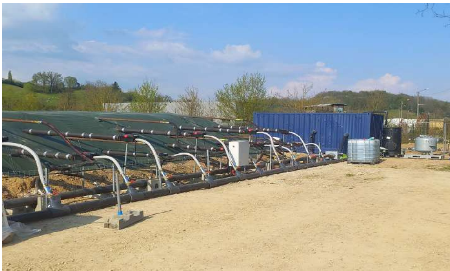
Figure 4 : installation de désorption tout électrique en pile
