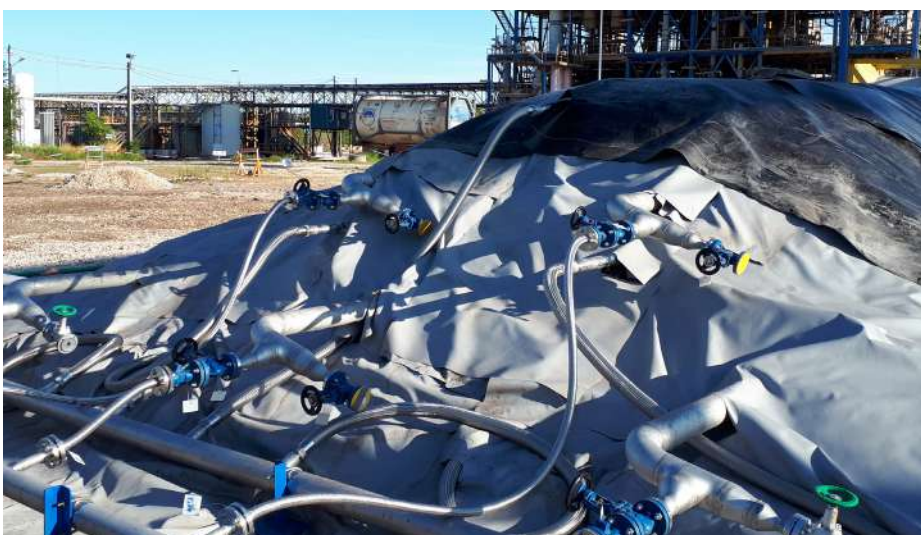
Figure 5 : chauffe d'une pile thermique à la vapeur du réseau industriel
