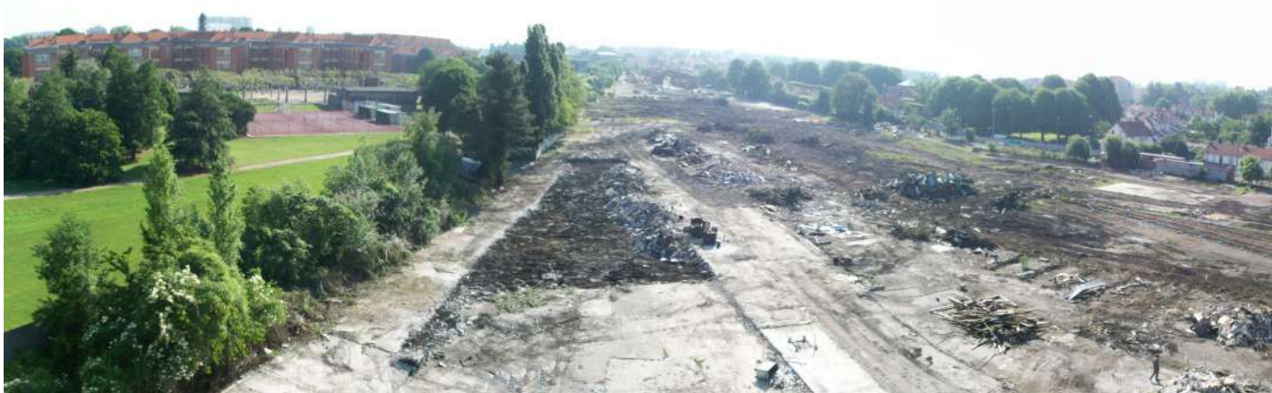
Tri des matériaux issus de la démolition et des terrassements pour valorisation, recyclage et réemploi
