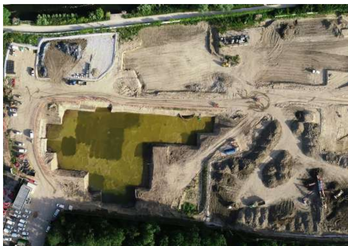
Vue aérienne du chantier, du maillage et des aires de stockage / traitement
