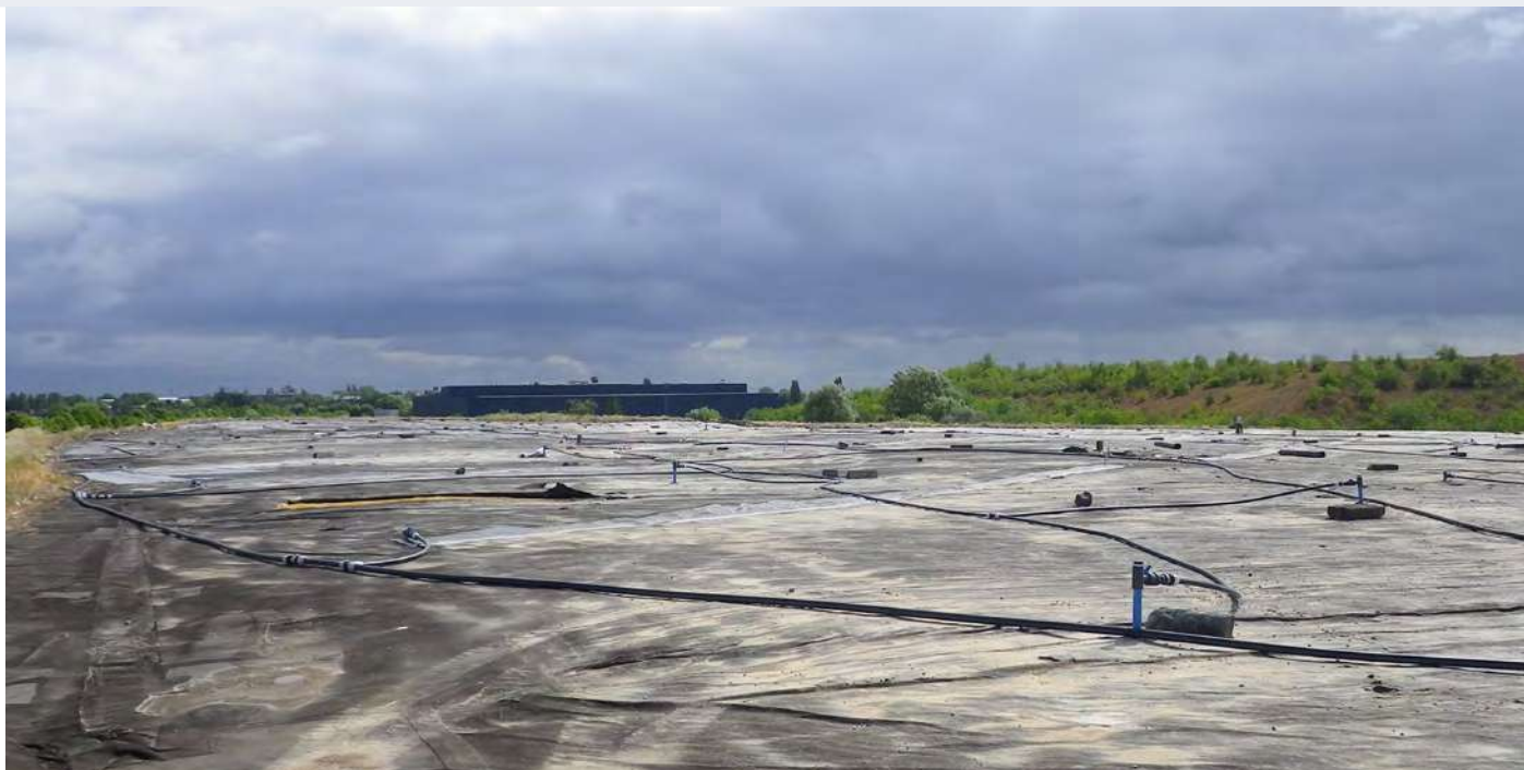
Figure 3 : réseau d'injection au toit du terril.
