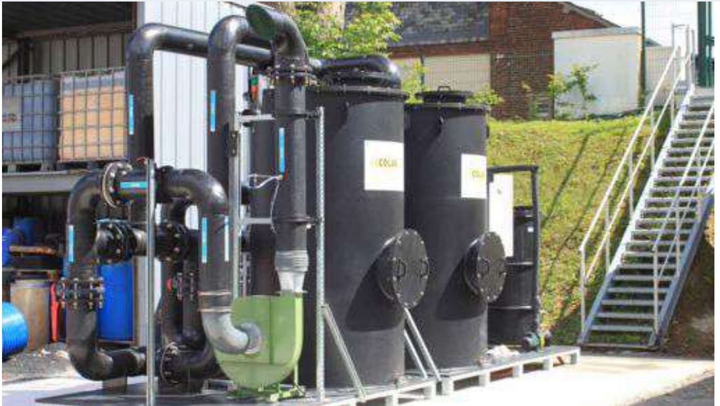
Skid de traitement des effluents gazeux
