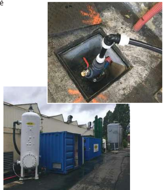
Figure 3 : Système d'extraction multi-phases et unités de traitement.
