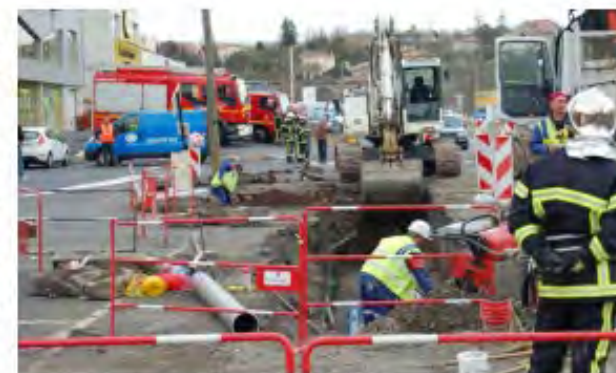
Figure 1 - Exemple d'endommagement de canalisation en zone urbaine
