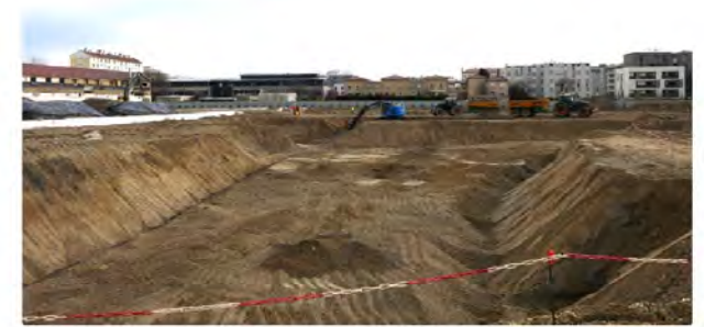
© Eric Sévigny - Plusieurs entreprises de dépollution des sites et des eaux adhérentes de l'Union des professionnels de la dépollution des sites sont déjà sur le pied de guerre en R&D sur le traitement des PEX.
