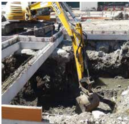
Exemple de travaux non anticipés
