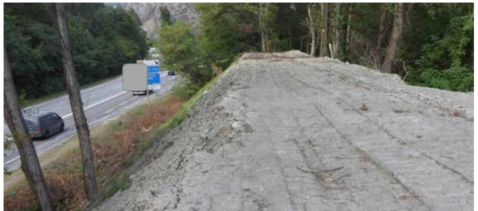
Réutilisation de déblais en remblais, profilés en merlon paysagé dont les conditions de stabilité géotechnique sont à contrôler
