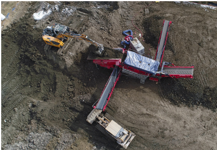
Vue aérienne du traitement par criblage capoté
