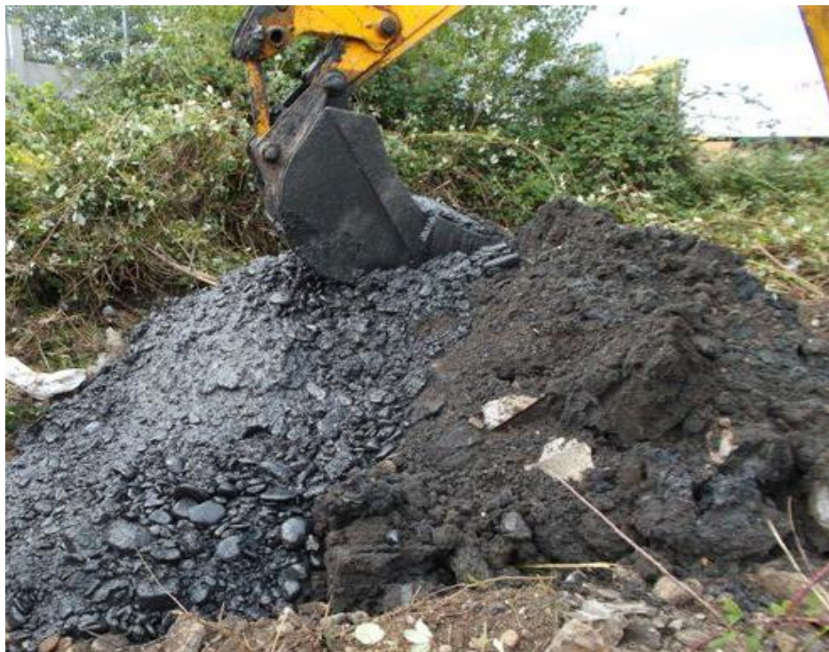
Figure 7 - Terrains imprégnés d'hydrocarbures lors de la réalisation d'une fouille
